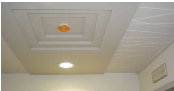
Soffitto cassettonato in gesso e piani smontabili lateralmente in cartongesso con incisioni.
